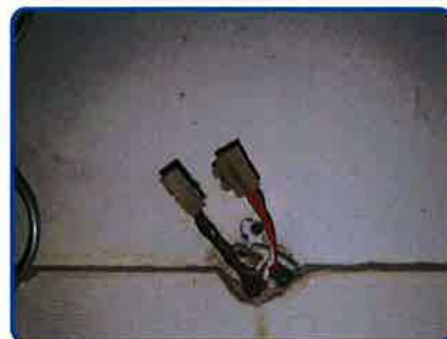
Anomalie B.7.3 d sur Install. n°1
