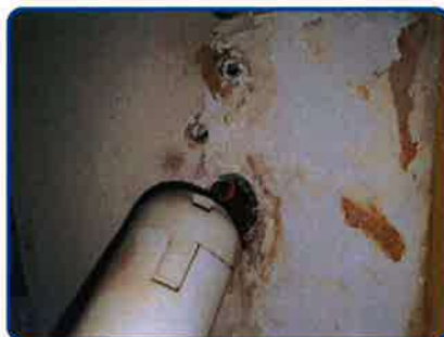
Anomalie B.3.3.6 a3 sur Install. n°1
