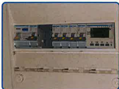
Anomalie B.7.3 d sur Install. n°1 App. n°1 (TRS n°1)
