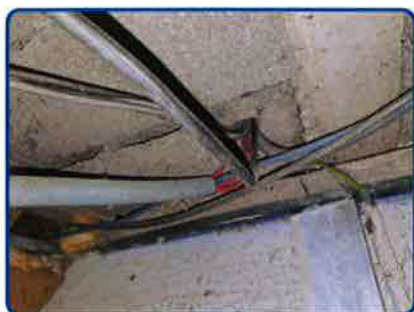
Anomalie B.8.3 e sur Install. n°1
