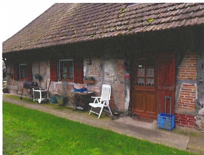
A gauche de la porte d'entrée, une poutre de la structure est vermoulue ou pourrie en partie basse.
