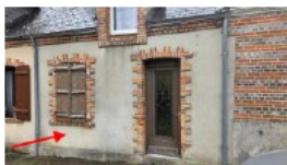
Fissuration en façade
