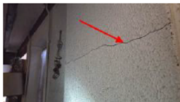
Fissuration sur murs intérieur.
