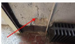
Présence d'humidité sur les murs de plusieurs pièces
