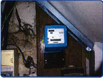
Anomalie B.7.3 d sur install. n°1
