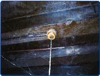
Anomalie B.8.3 a sur install. n°1
