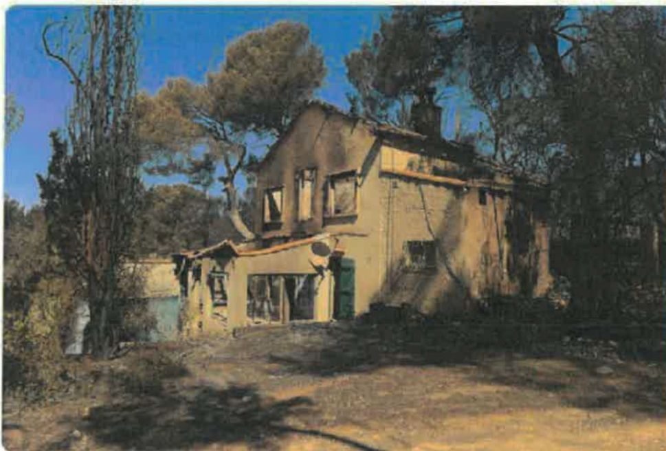
Maison non débroussaillée, partiellement détruite par le passage d'un feu, Rognec (13), source : ONF.
