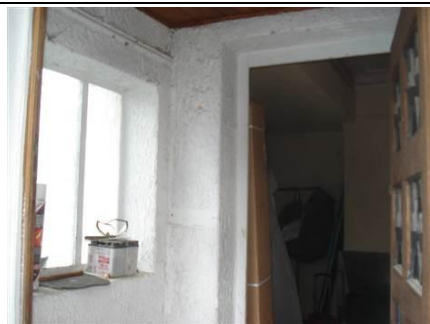
Photo n° PhA002 Localisation : Ancienne entrée Ouvrage : Murs, Cloisons "en dur" et Poteaux (périphériques et intérieurs) Partie d'ouvrage : Enduits projetés Description : Crépi blanc - Mur Localisation sur croquis : P2
