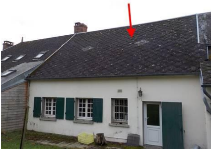
Photo n° PhA001 Localisation : Extérieur - Maison Ouvrage : Bardages et façades légères Partie d'ouvrage : Ardoises (fibres-ciment) Description : Ardoises (fibres-ciment) Localisation sur croquis : M001
