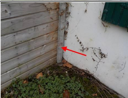
Photo n° PhA002 Localisation : Extérieur - Maison Ouvrage : Conduits en toiture et façade Partie d'ouvrage : Conduites en amiante-ciment Description : Conduite en amiante-ciment Localisation sur croquis : M002
