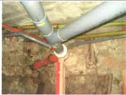
Photo n° PhA004 Localisation : Vide-sanitaires Ouvrage : Conduits de fluides (air, eau, autres fluides) Partie d'ouvrage : Conduits Description : Conduit fonte et PVC - Evacuation Localisation sur croquis : M4
