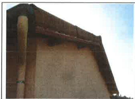
Photo n° PhA001 Localisation : Toiture maison Ouvrage : Toitures Partie d'ouvrage : Accessoires de couvertures (fibres-ciment) Description : Closoirs de rive amiante ciment Localisation sur croquis : P1
