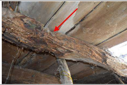
Photo n° PHOTO 2 Localisation sur croquis : 2IEME ETAGE - CHAMBRE 6 Indices : Présences de fortes altérations sur la solive de la chambre 6 et dans les combles empêchant tout cheminement sécurisé.
