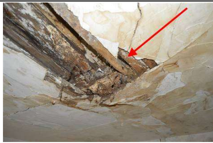
Photo n° PHOTO 1 Localisation sur croquis : 2IEME ETAGE - CHAMBRE 6 Indices : Présences de fortes altérations sur la solive de la chambre 6 et dans les combles empêchant tout cheminement sécurisé.
