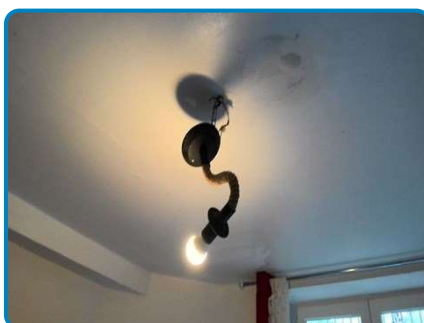
Anomalie B.7.3 d sur Install. n°1
