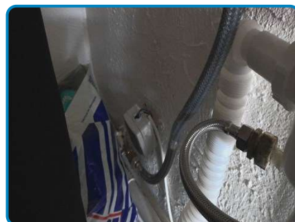
Anomalie B.7.3 a sur Install. n°3
