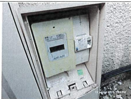
Photo du Compteur électrique
